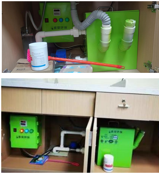
医疗废水处理设施
